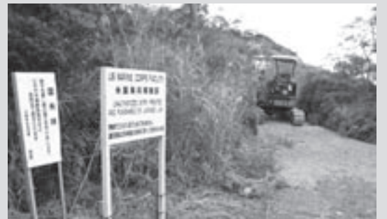
ヘリパットが建設されるヤンバルの森への取り付け道路の工事は進行中だ
